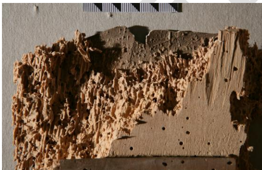
3. Koks – ķīmju/koksngrauzņu bojājums ar koksnes zudumu.
