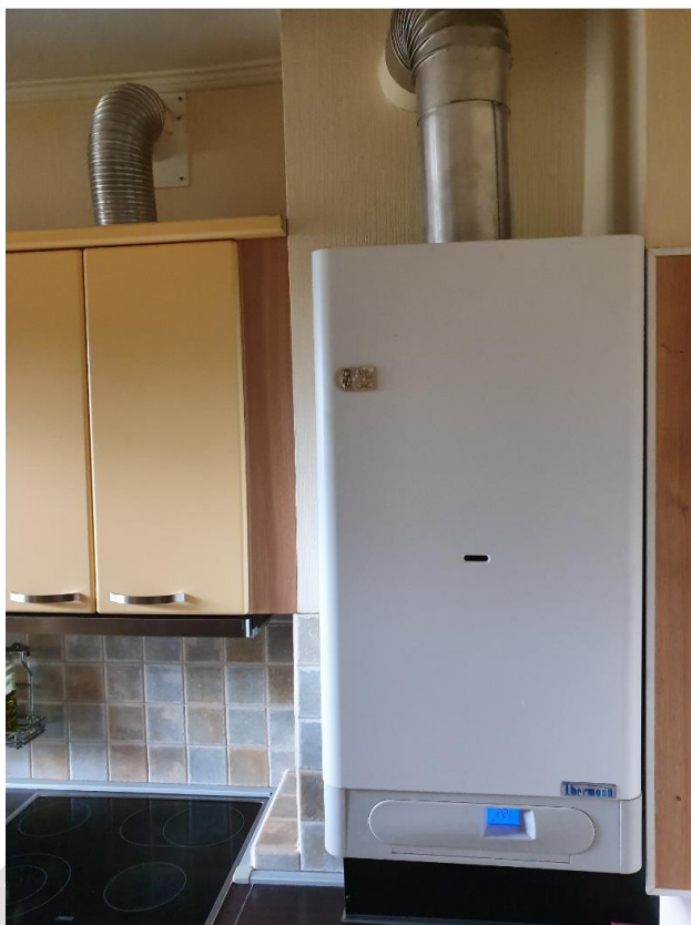
1. attēls. Gazificētas telpas (virtuves) iekārtojums
