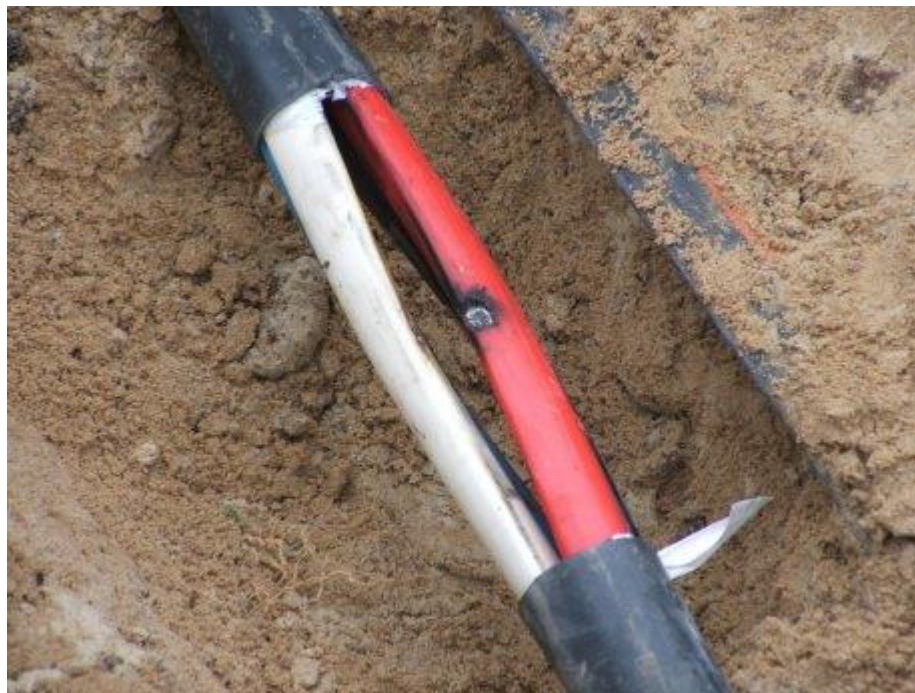
1. attēls. Kabeļlīnijas bojājumi
