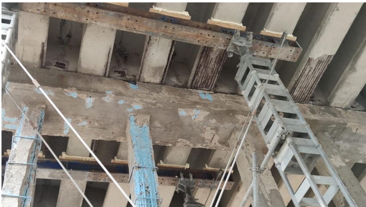
4. attēls. Tilta balsta bojājums
