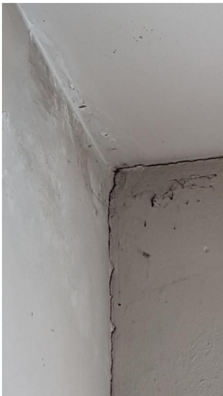
3. attēls. Griestu tehniskais stāvoklis 1
