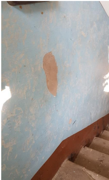
9. attēls. Sienu tehniskais stāvoklis 5
