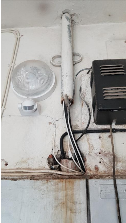
5. attēls. Sienu tehniskais stāvoklis 1
