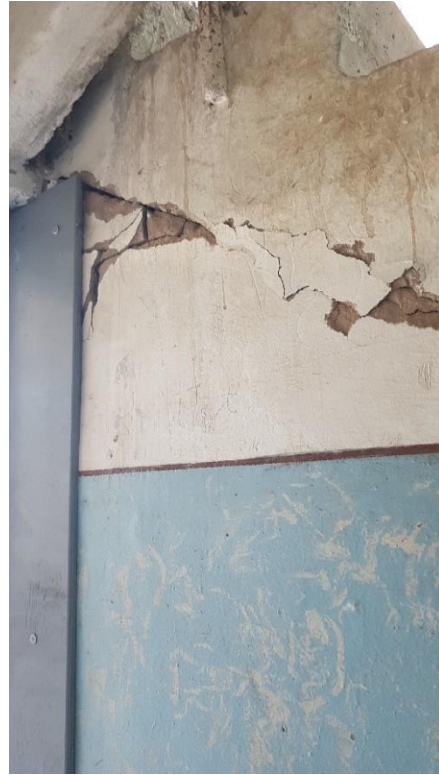
6. attēls. Sienu tehniskais stāvoklis 2
