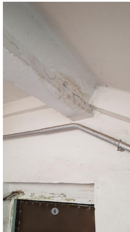
4. attēls. Griestu tehniskais stāvoklis 2
