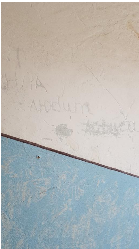
7. attēls. Sienu tehniskais stāvoklis 3
