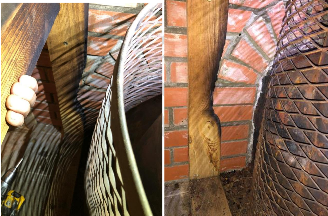
3. attēls. Nedroši izbūvēta apkures iekārta
